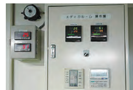
コントロール制御盤 （温度25℃・湿度30～50%）
